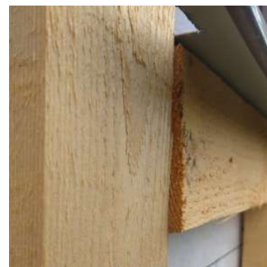
Обрешетка не в плоскости. Перекрыт вентиляционный канал.
