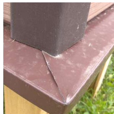
Нет зазора между доборным элементом и отливом.
