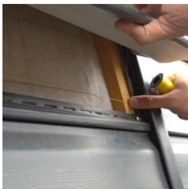
Утеплитель выпирает наружу. Перекрывает вентканал, выталкивает сайдинг.
