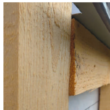
Обрешетка не в плоскости. Перекрыт вентиляционный канал.
