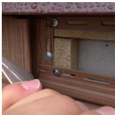
Саморезы вкручены в тело доборного элемента и края перфорации. Отсутствует зазор между шляпкой самореза и доборным элементом. Перекрыт вентканал.
