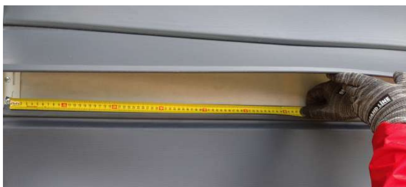
Мембрана неверно смонтирована. Должна быть смонтирована под обрешеткой. Саморезы в тело доборного элемента. Неверный шаг обрешетки.
